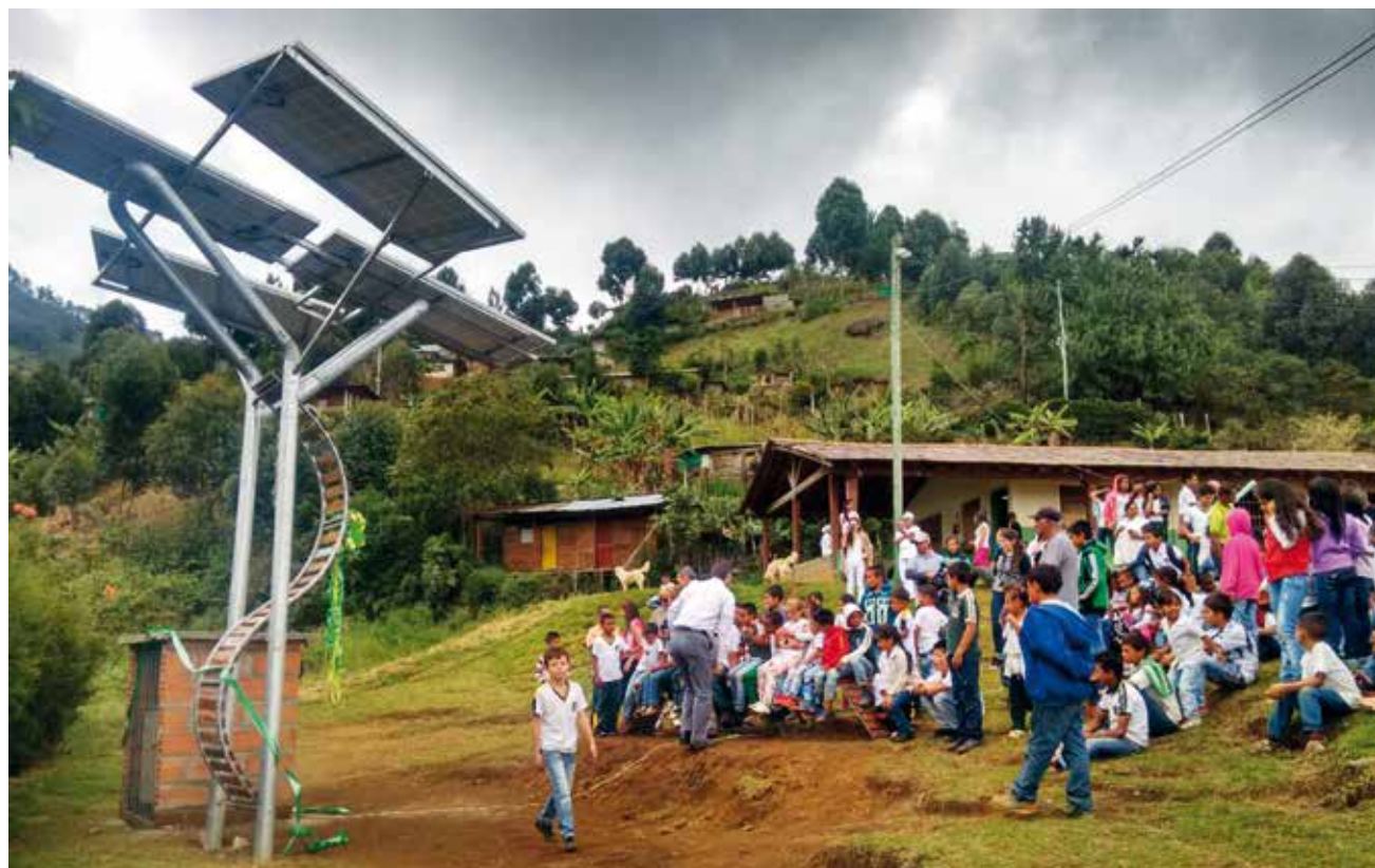
Instalación de una estación solar fotovoltaica en la institución Altos de Oriente, en el municipio de Bello. Fotografía cortesía grupo de investigación.
