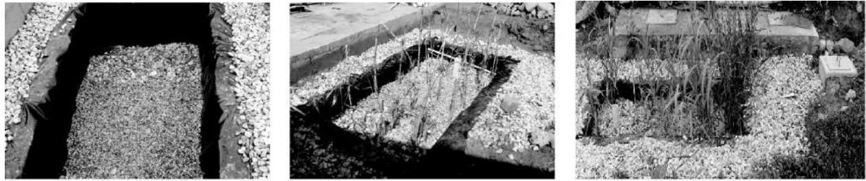
Figura 6. Construcción, maduración y tratamiento del humedal de flujo subsuperficial HPSS a escala real, en la vereda El Zango, municipio de Guarne.
