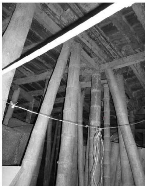
Figura 1. Refuerzo artesanal de la estructura.
