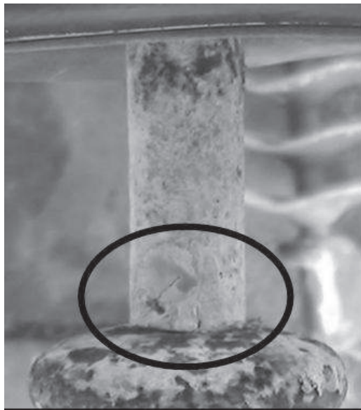
a) Grieta en aislador
