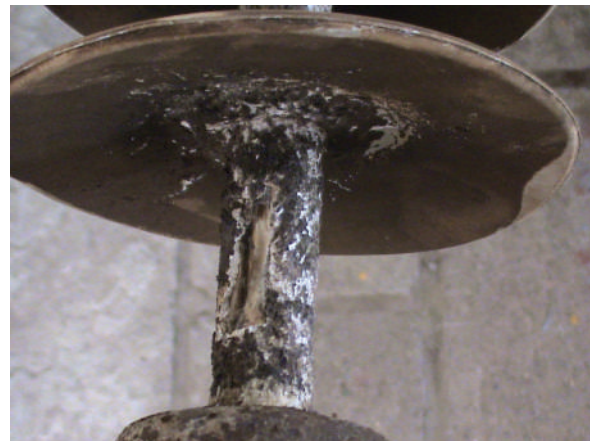
Figura 1 Daño en el aislador detectado con cámara corona.
