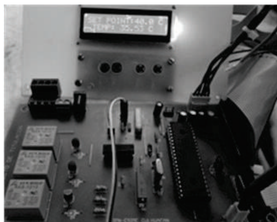
Figura 24 Funcionamiento de display y del sistema de control
