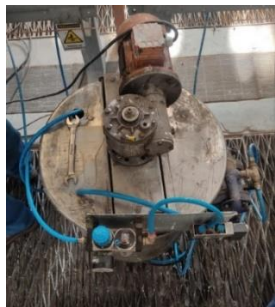
Figura 21. Bomba de llenado de granilla
