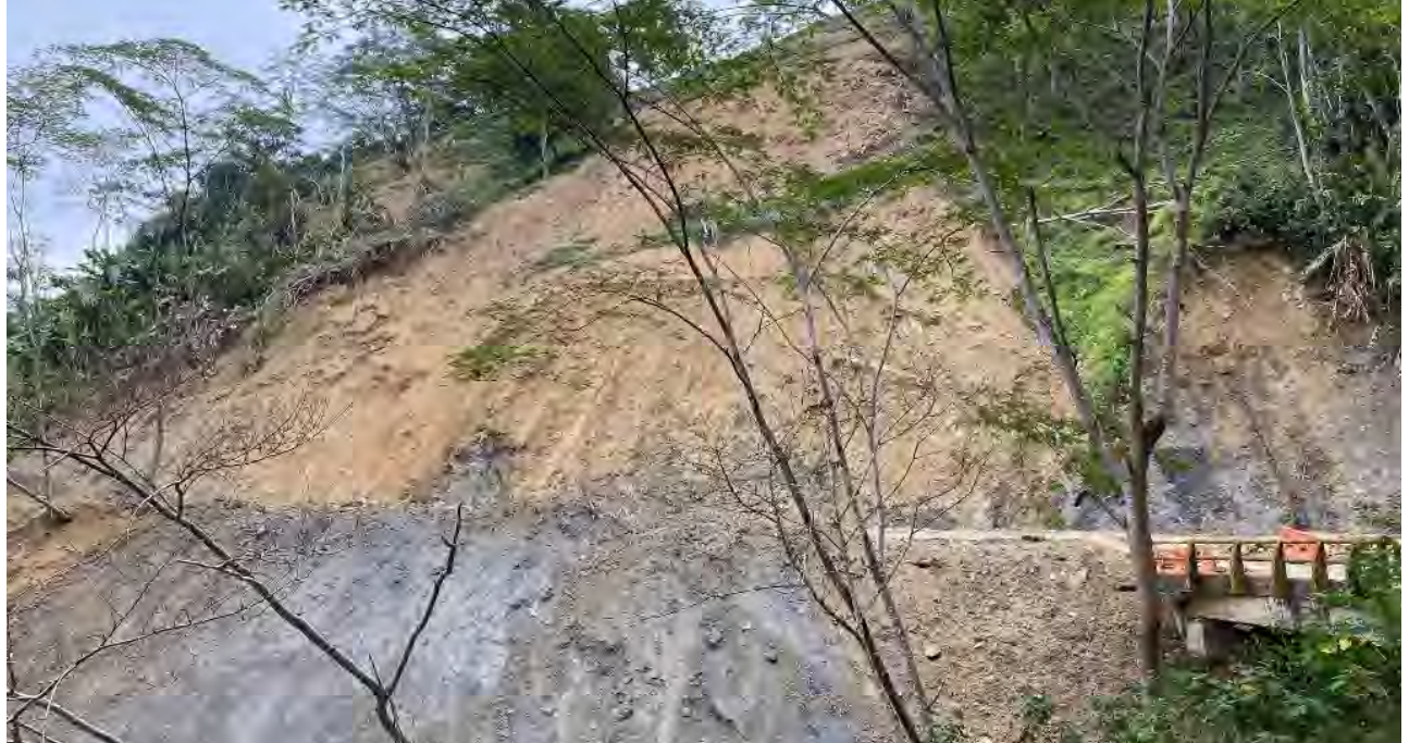
Ilustración 4. Talud intervenido en febrero del 2023, Quebrada la sucia. Nota: Elaboración propia. Tomada el 01/03/2023.
